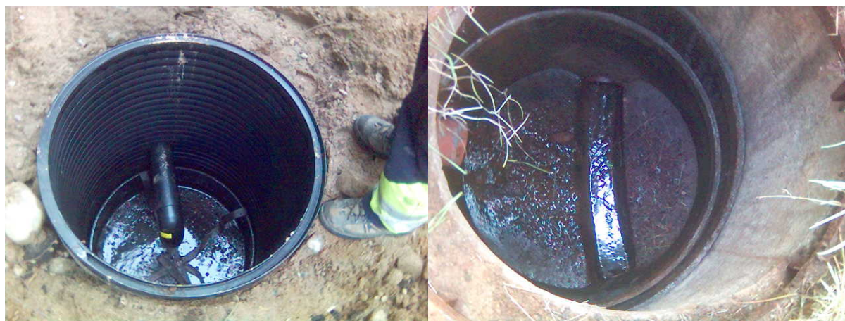
Figur 6. Bilden till vänster visar AXON Miljöfilterbrunn uppifrån. Ofiltrerat vatten kommer ut ur visuellt rör. Bilden till höger visar inspektionsbrunn med filtrerad vattenfas efter AXON Miljöfilter.
