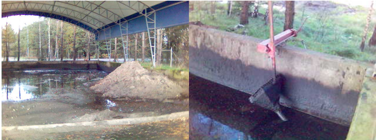
Figur 3, Bilden till vänster visar oljeplattan under tak. Bilden till höger visar det manuellt nedsänkbara system som är beläget i oljeplattans högra hörn.
